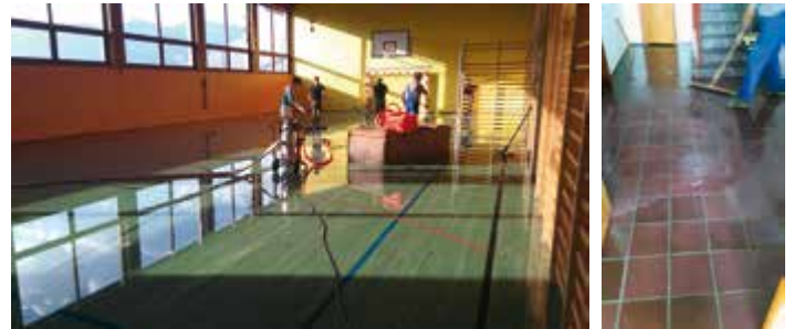
Der Turnsaal unter Wasser
